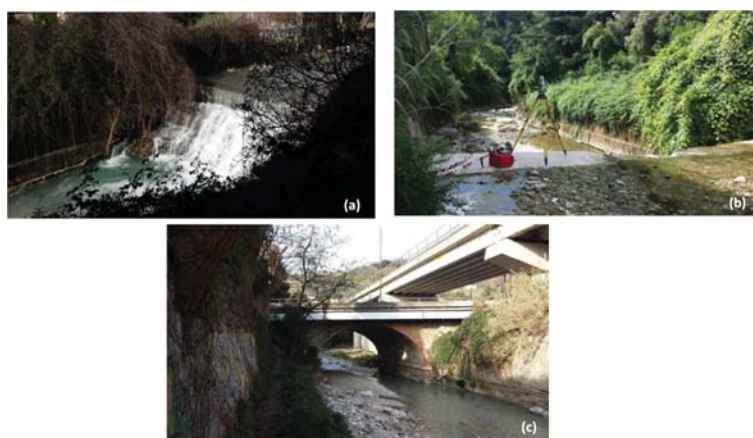
Figura 1.31: Soglia localizzata alla sezione 68.1, vista da valle (a) e da monte (b). Ponte di Via XX Settembre, localizzato in corrispondenza della sezione 71, visto da monte (c)
