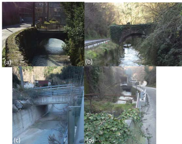
Figura 3.20: Passerelle pedonali lungo il Fosso di Torano (a, b), nella parte alta del Torano in località Pianello (c) e nella parte bassa del Colonnata (d)
