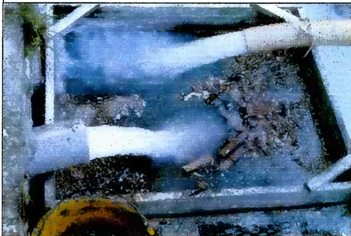
Figura 33 - Pozzetto di raccolta dei reflui (A) (foto eseguita da D. Basilio in una segheria a Carrara).
