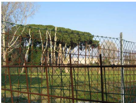
> Recinzione precaria lato via Marco Polo
