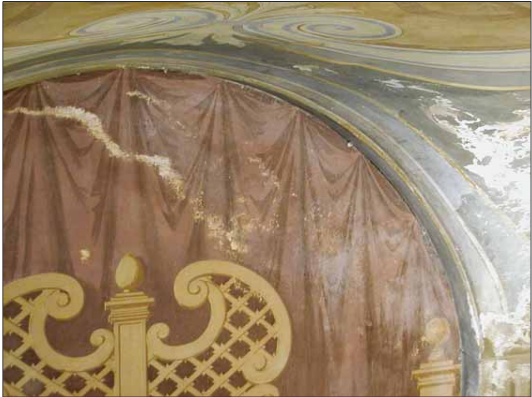
Figura III/29 – Alterazione del fissativo interessante parte di un matroneo
