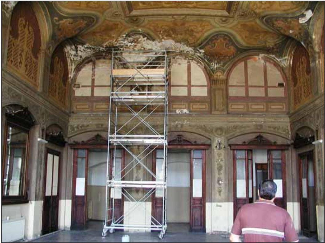
Figura III/1 – Interno del Salone Germinal prima del restauro, degrado della parete nord
