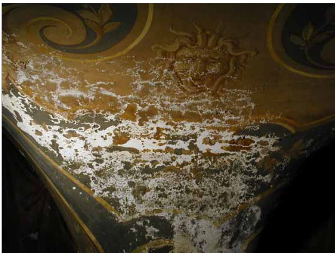
Figura III/15 – Perdita di zone di superficie pittorica causata dalla fuoriuscita dei sali
