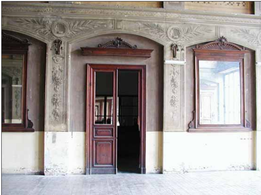
Figura III/18 – Degrado della parte bassa del Salone: mani di vernice sintetica bianca sotto le lesene
