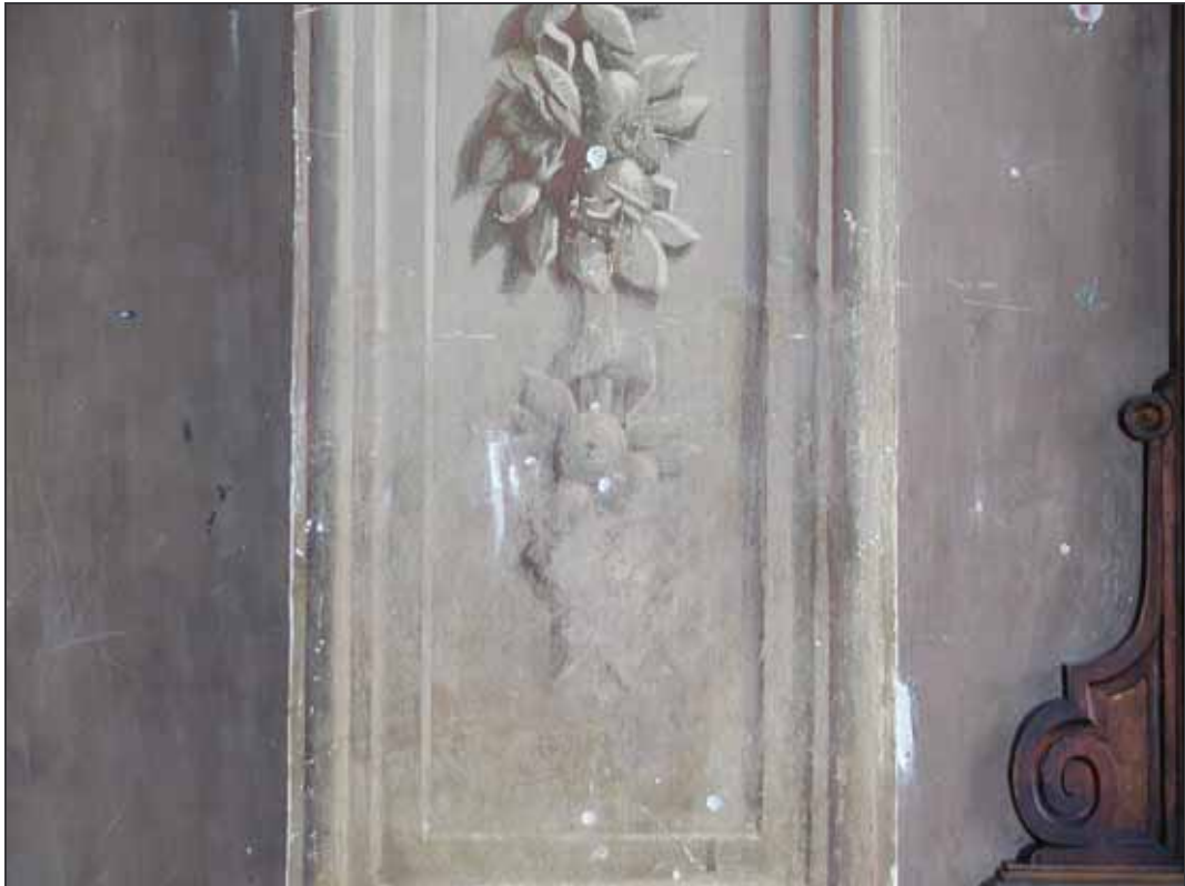
Figura III/17 – Degrado delle lesene nella zona sottostante il cornicione: fori, graffi, perdita del film pittorico
