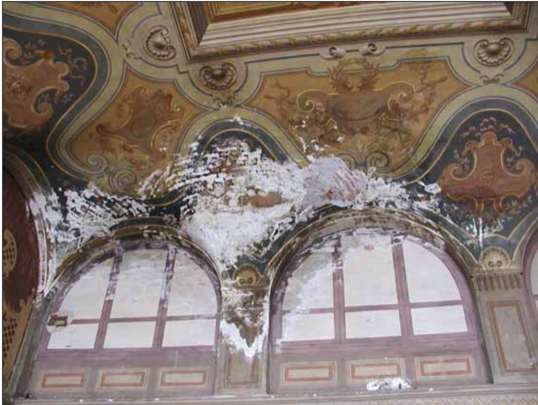
Figura III/3- Parete nord compromessa dalle numerose e persistenti infiltrazioni d'acqua
