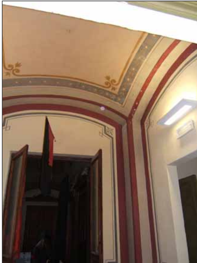
Figura IV/15 – Ingresso del “Salone Germinal”: comparsa di macchie scure causate dall’umidità
