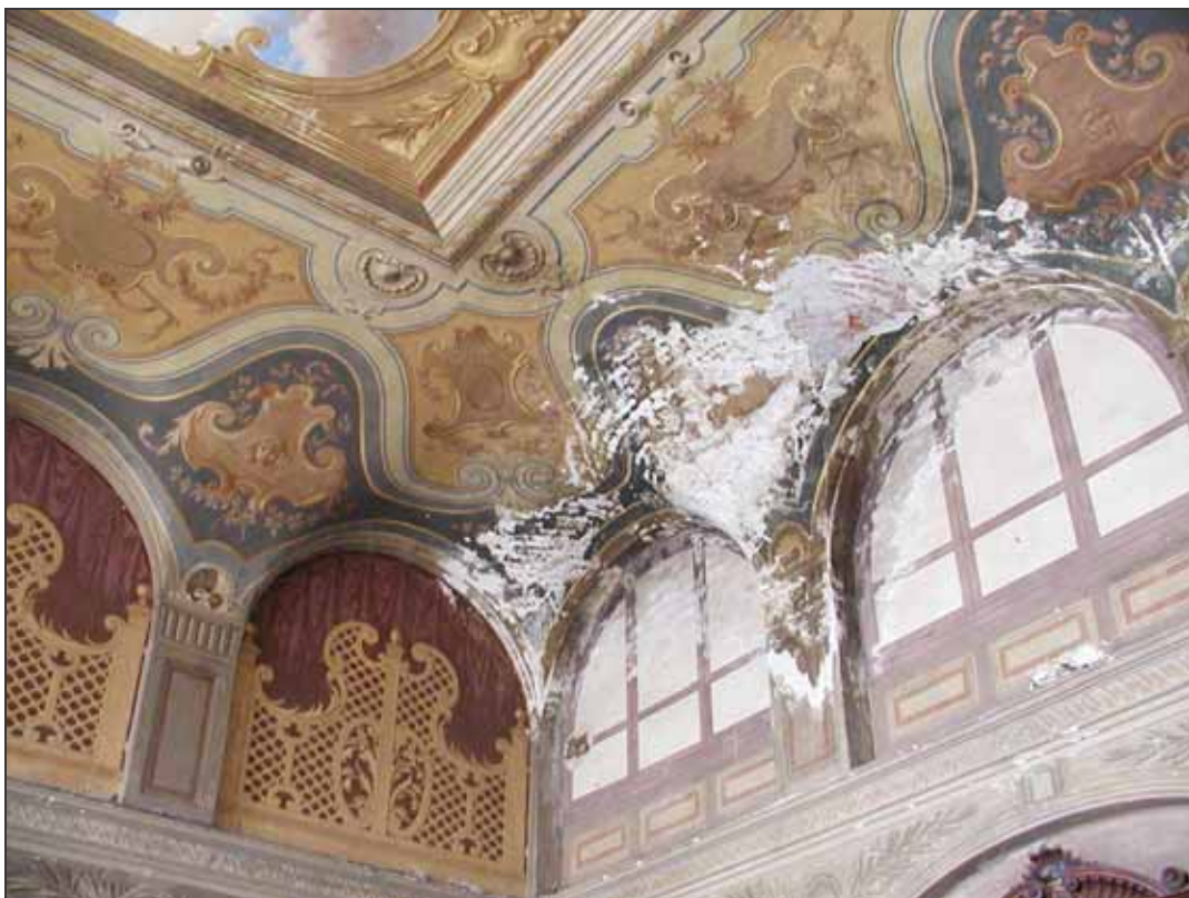
Figura III/4- Perdita del film pittorico e caduta di intonaco e arriccio sottostante, parete nord
