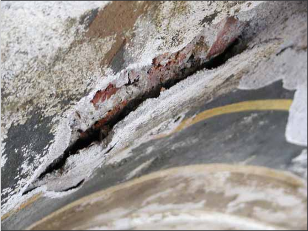
Figura III/5 – Distacco dello strato di intonaco con formazione di profonde crepe, particolare
