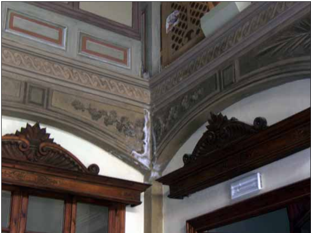
Figura IV/12 – Nuova fuoriuscita di sali idrosolubili sotto forma di filamenti, angolo nord-est
