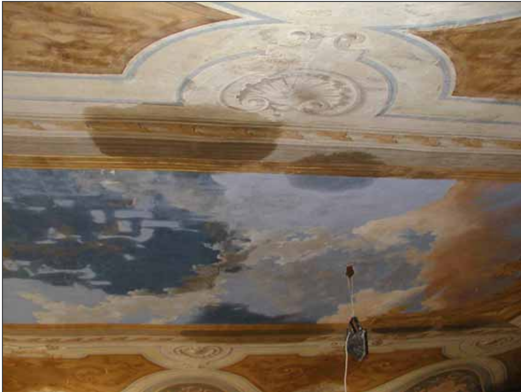
Figura III/9 – Comparsa di ampie macchie di umidità sul soffitto
