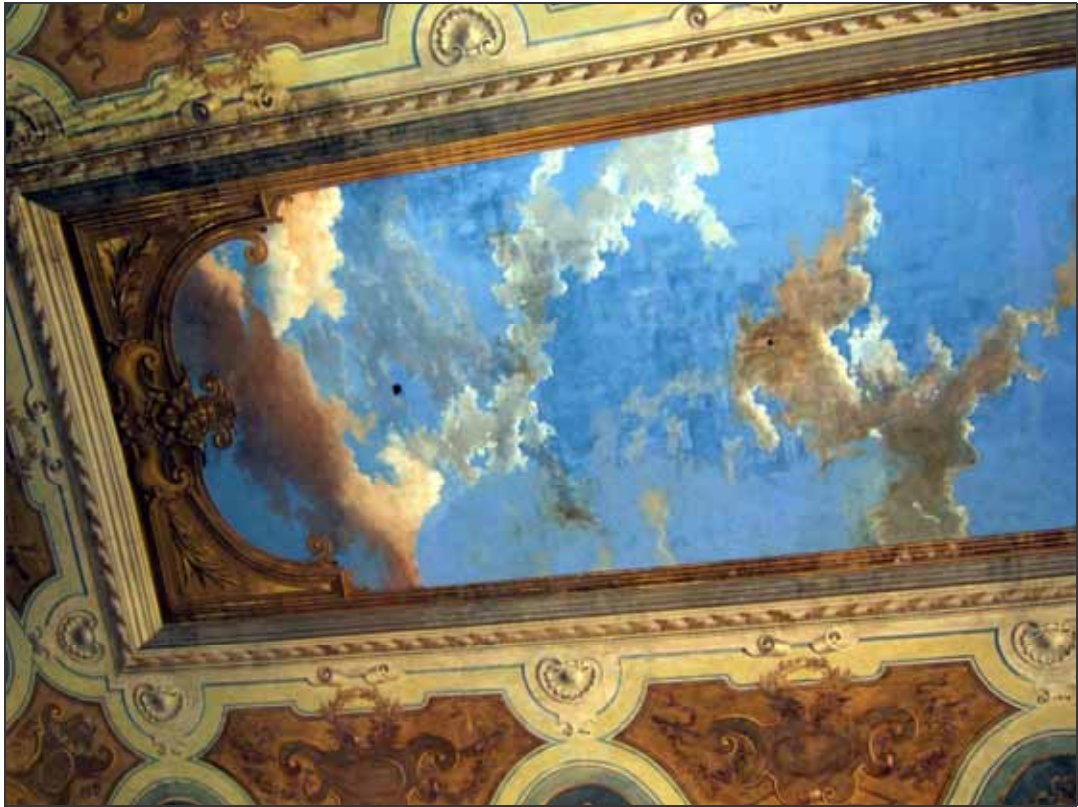
Figura IV/9 – Ricomparsa di estese macchie di umidità sul soffitto, luglio 2006
