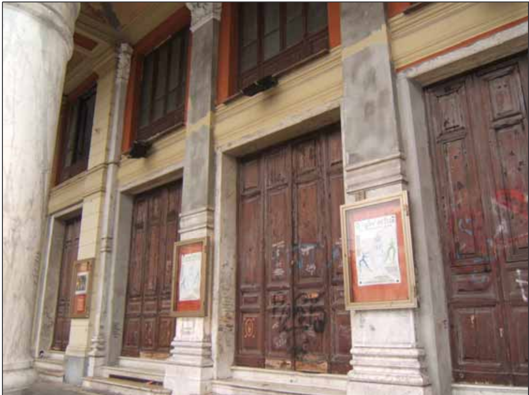
Figura IV/2 – Il Teatro- Cinema chiuso e abbandonato in evidente stato di degrado e incuria
