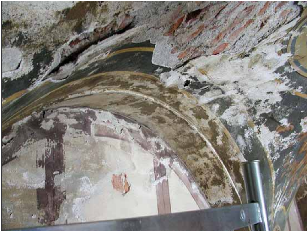
Figura III/7 – Crollo dell' intonaco con presenza di mattoni a vista, parete nord
