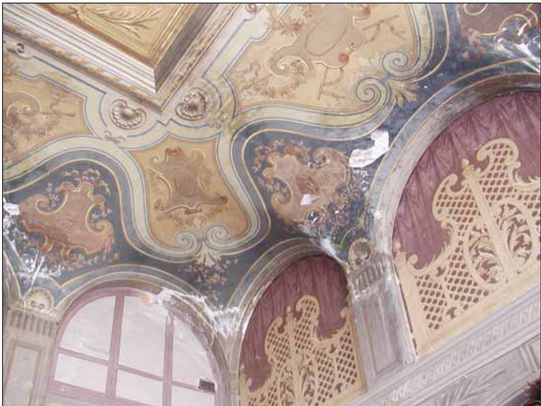
Figura III/2 – Degrado della superficie pittorica causato dalle infiltrazioni d'acqua
