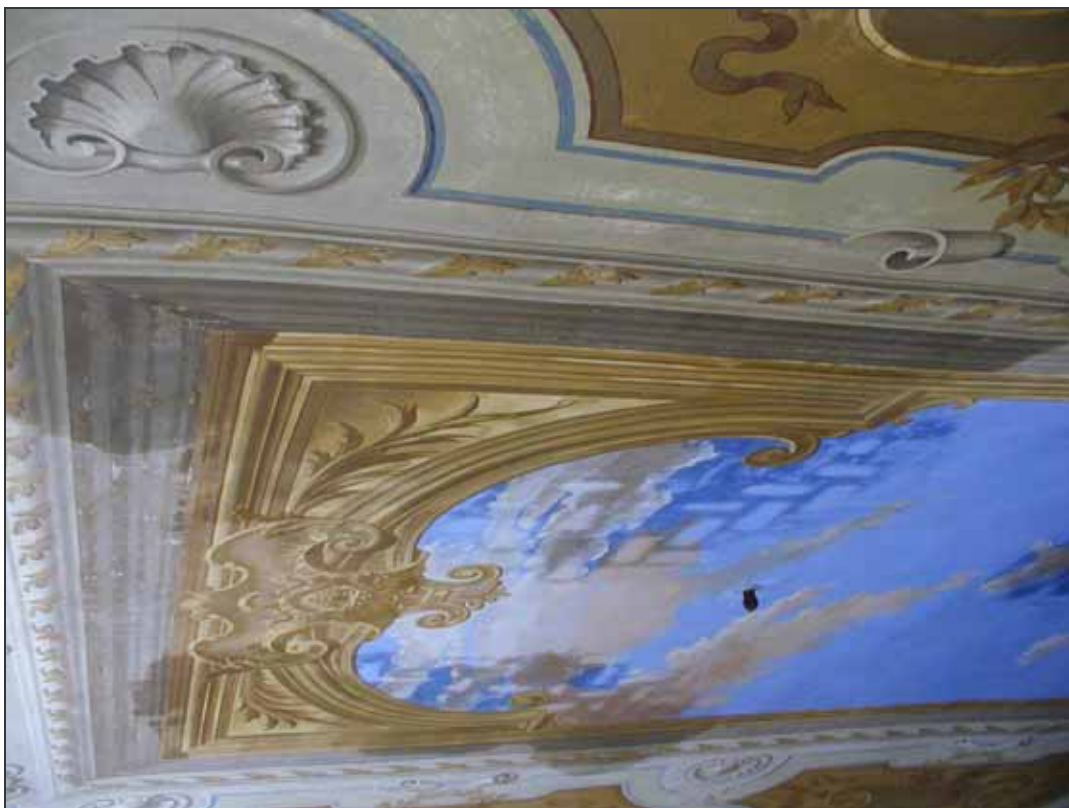
Figura III/10 – Macchie di umidità causate da infiltrazioni d'acqua provenienti dai piani superiori
