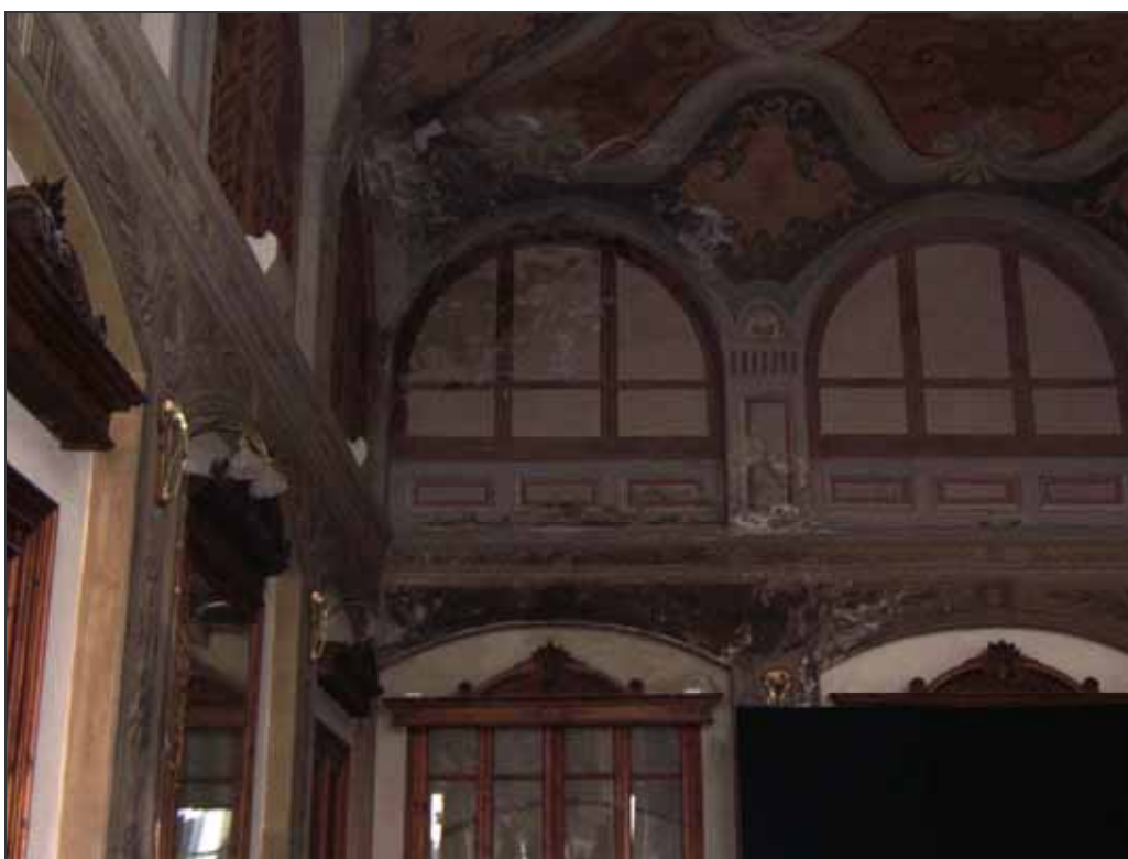
Figura IV/7 – Ricomparsa della situazione di degrado dovuta alle infiltrazioni d’acqua non ancora sanate provenienti dai piani superiori, settembre 2006
