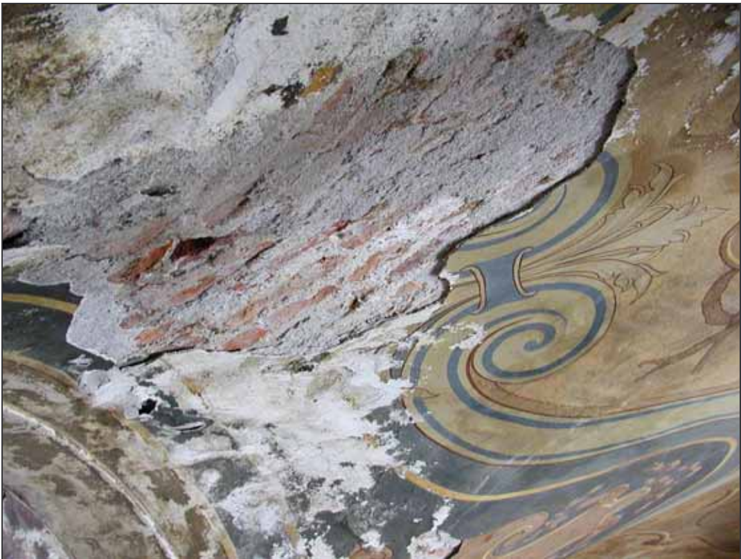
Figura III/6 – Crollo della superficie pittorica e comparsa dei mattoni della muratura sottostante
