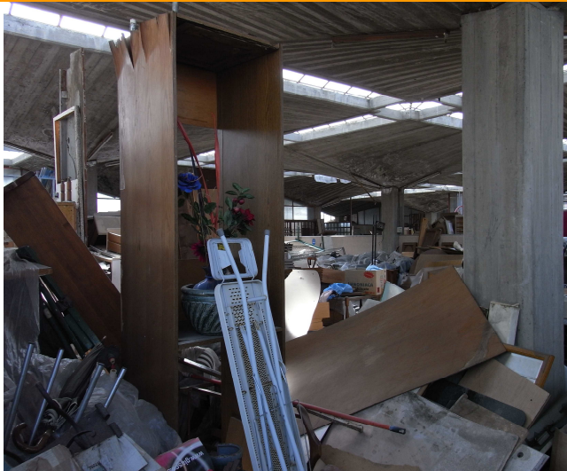
Sopra ed a destra: degrado attuale interno
