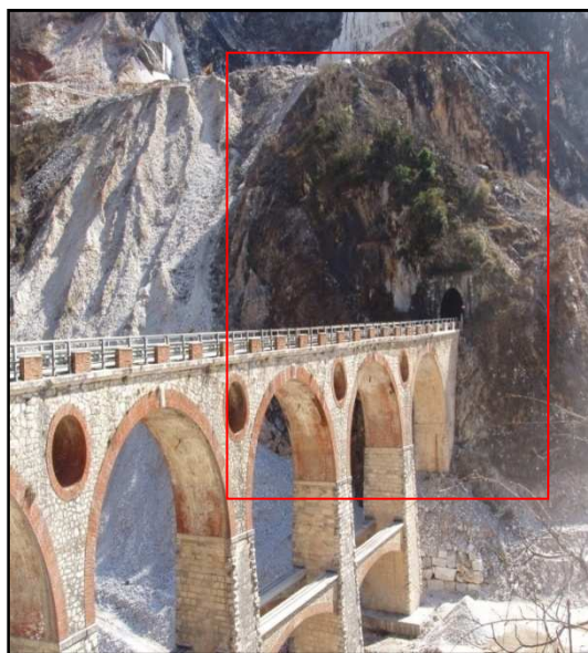
Figura 17: Particolare di un ponte di Vara, 8/03/09, la parte evidenziata mostra la totale asportazione del ravaneto, avvenuta di recente.
